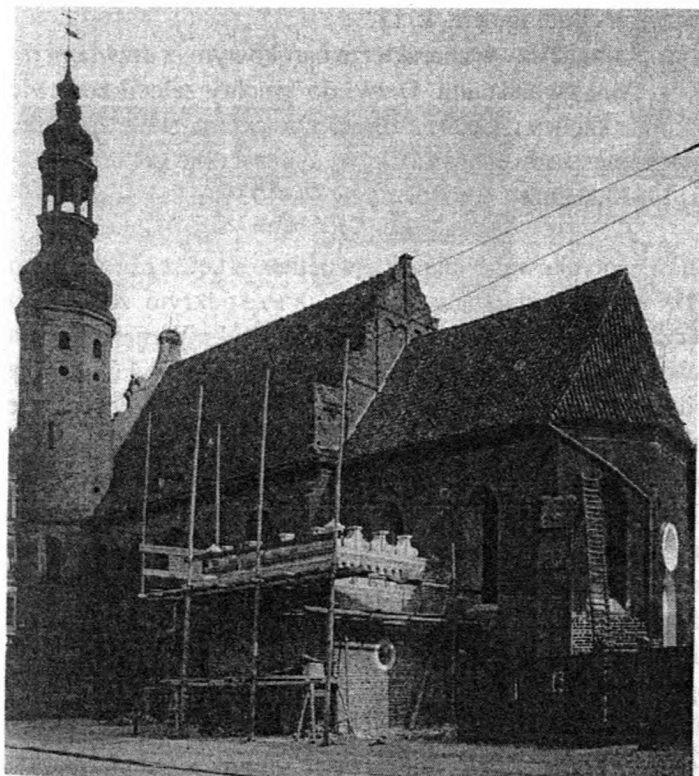
Kościół Klarysek, elewacja południowa podczas remontu przybudówki, ok. 1921-1922 r., AZFiRP IS PAN, sygn. B 266
