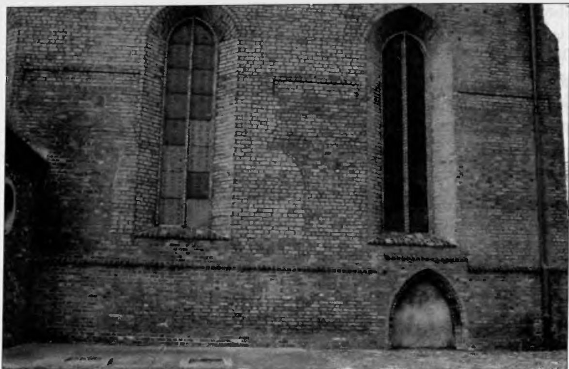
4. Fara. Mur północny korpusu nawowego z portalem i śladami trzech zamurowanych okien wcześniejszego budynku kościelnego.
